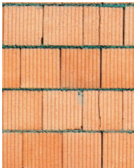
Bild 12 Über mehrere Steinlagen hinweggehender Riss z. B. aus Bauwerkssetzungen
